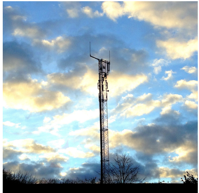
Weit über 400 Basisstationen sorgen bald in Nordrhein-Westfalen für eine flächendeckende Digitalfunkversorgung.
