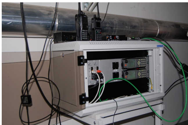
Bild: Gebäudefunkanlage im Flughafen Münster/Osnabrück
